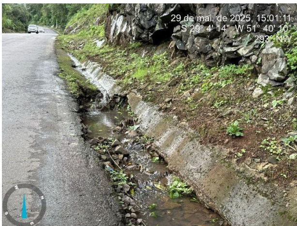
Foto 7: Danos nos elementos de drenagem em vistoria de maio/2025
