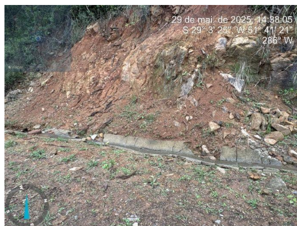
Foto 4: Talude Instável em vistoria de maio/2025
