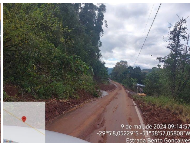
Foto 2: Deslizamentos na Estrada Bento Gonçalves em 2024 – 02/03
