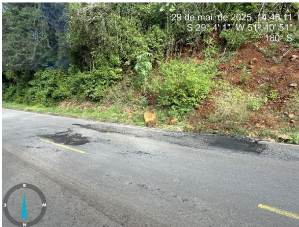
Foto 5: Talude Instável e danos no pavimento em vistoria de maio/2025
