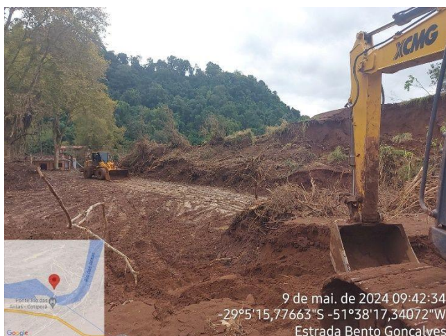
Foto 1: Deslizamentos na Estrada Bento Gonçalves em 2024 – 01/03
