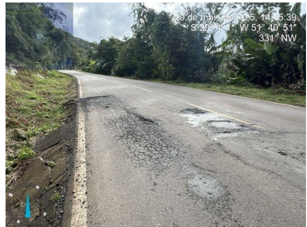
Foto 6: Danos no pavimento em vistoria de maio/2025
